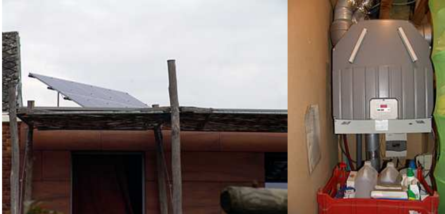
Capteurs solaires et groupe de ventilation double flux avec échangeur de chaleur. Maisons passives Heusden (Gand) 2005.
